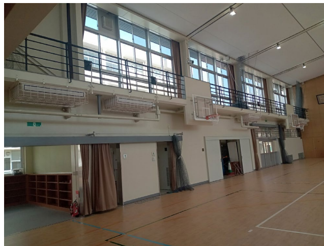
図 34 体育館に設置している空調設備
