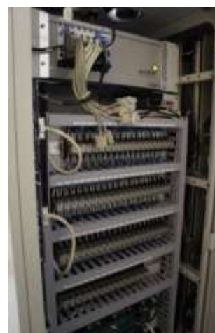
写真 4 本機制御コンピューター
