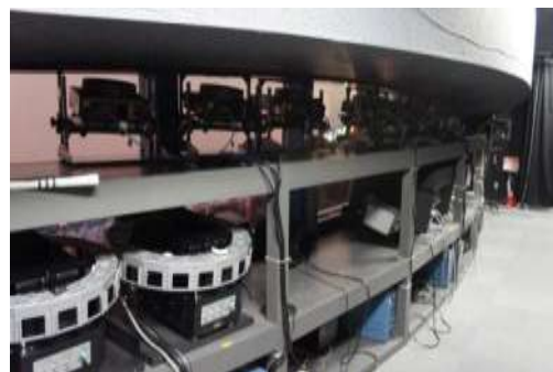
写真7 3面マルチ映像システム部
