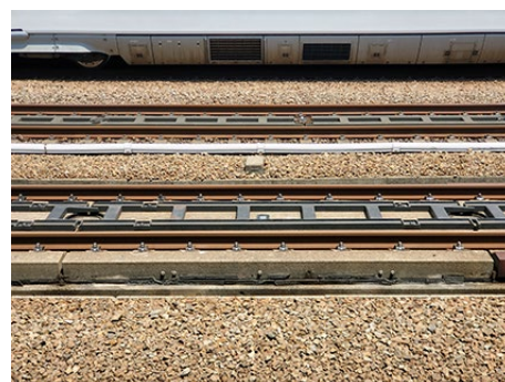
写真4 スラブ軌道(中央) (姫路駅・新幹線)
