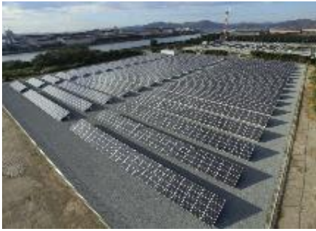
太陽光発電システム（中部析水苑）
