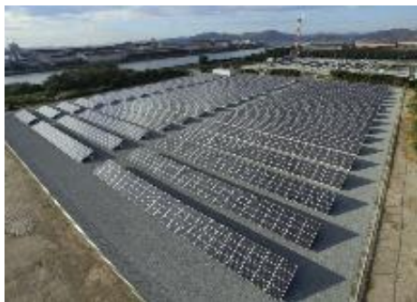
太陽光発電システム（中部析水苑）
