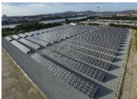
太陽光発電システム（中部析水苑）
