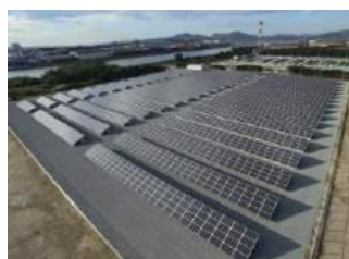
太陽光発電システム （中部析水苑）
