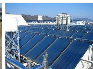
太陽熱利用システム （総合スポーツ会館）
