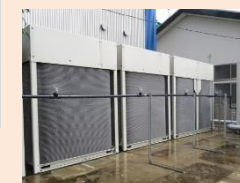
室外機への散水
