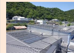
工場屋根の太陽光発電
