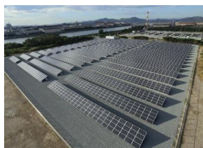
太陽光発電システム （中部析水苑）
