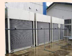
室外機への散水
