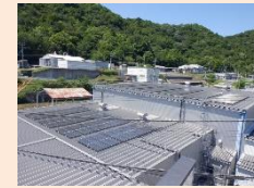
工場屋根の太陽光発電
