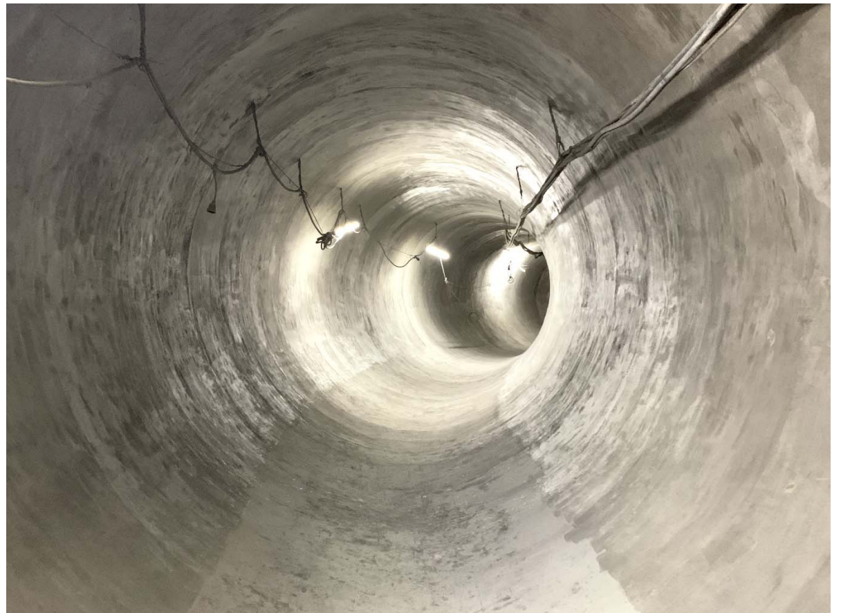
二次覆工(モルタル吹付)の完了した鋼製セグメント区間 二次覆工は鉄を腐食から守り、スムーズに水が流れるようにする役割を担っています
