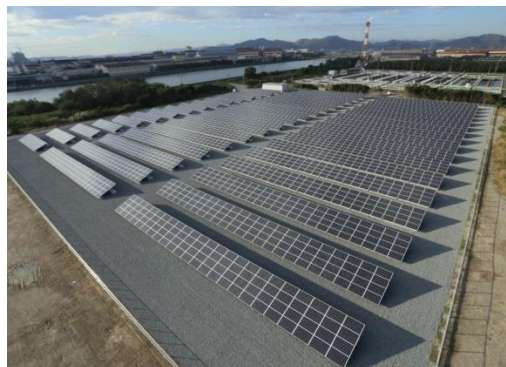
中部析水苑の太陽光発電施設
