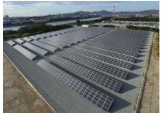
中部析水苑の太陽光発電施設
