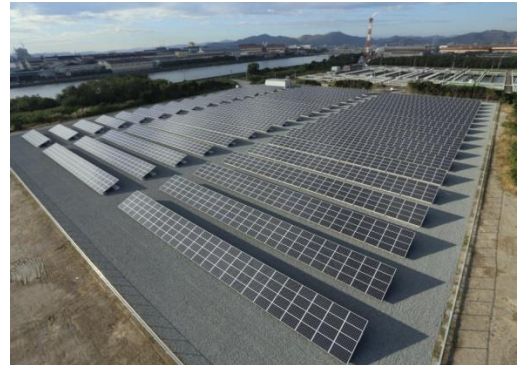
中部析水苑の太陽光発電施設
