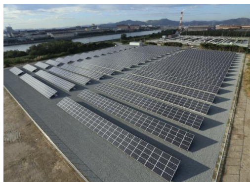
中部析水苑の太陽光発電施設
