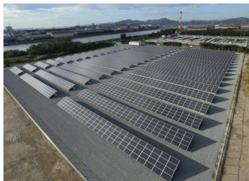
中部析水苑の太陽光発電施設
