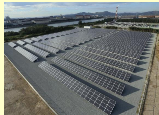
中部析水苑の太陽光発電施設
