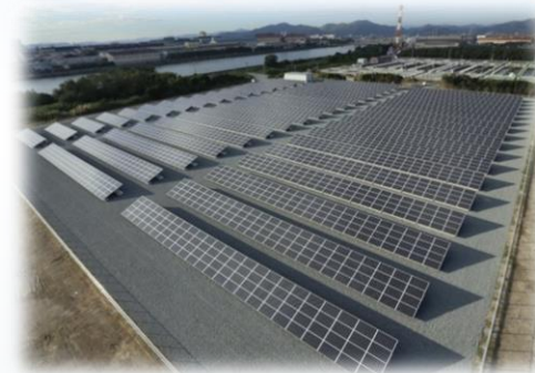
中部析水苑の太陽光発電施設
