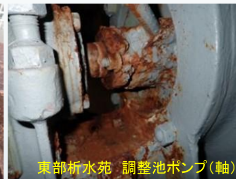
東部析水苑 調整池攪拌設備
