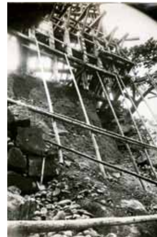
昭和の大修理の発端となった崩壊
