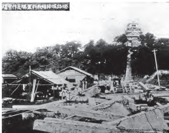
修理中の姫路城（兵庫県立歴史博物館蔵（高橋秀吉コレクション））
