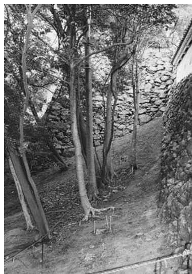
【乾郭西側原生林側石垣下の瓦礫の堆積】
