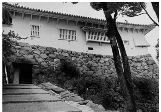
【帯の櫓南面石垣の反り上がりの状態】
