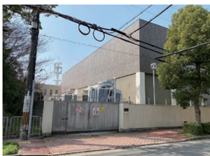
⑭関西電力総社変電所
