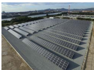
太陽光発電システム （中部析水苑）
