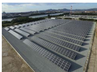
太陽光発電システム （中部析水苑）
