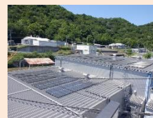
工場屋根の太陽光発電
