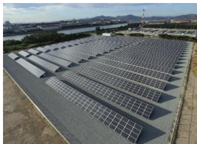
太陽光発電システム （中部析水苑）
