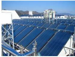
<太陽光発電（防災センター）>
