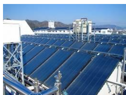
<太陽光発電（防災センター）>
