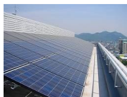
<太陽熱利用（総合スポーツ会館）>
