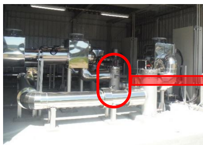
【 紫外線処理設備 】
