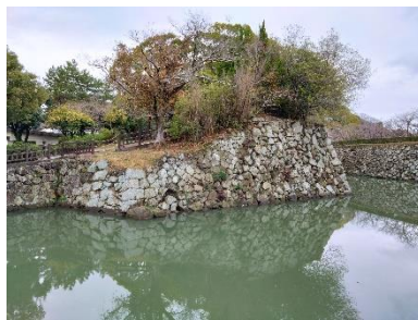
東部内堀石垣崩れ
