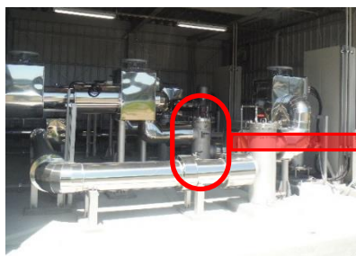
【紫外線処理設備】
