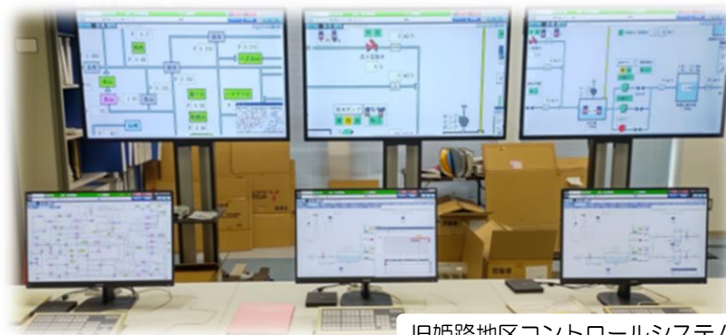
旧姫路地区コントロールシステム
