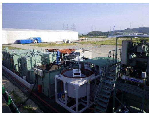
写真 2-1 排水処理施設
