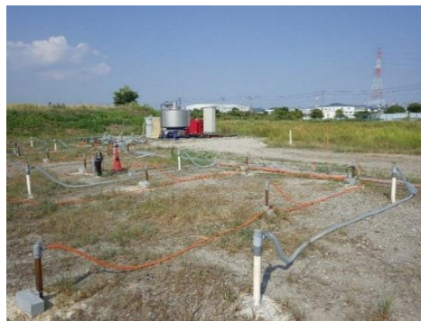
写真 5-2 エアースパーキング配管
