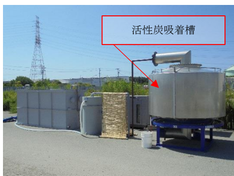
写真 5-1 エアースパーキングユニット
