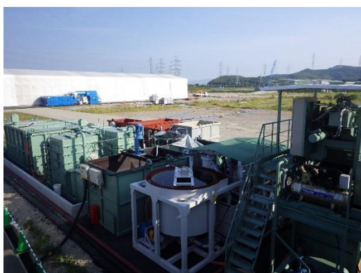
写真 2-4 排水処理施設
