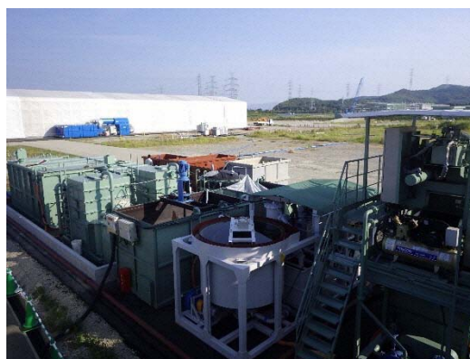
写真 6-1 排水処理施設
