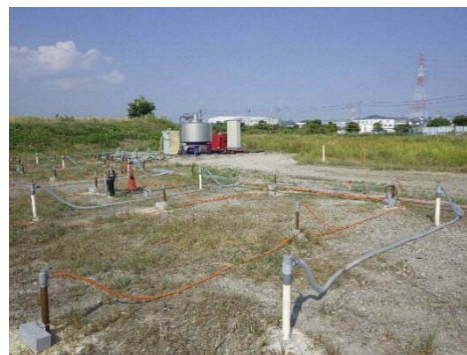
写真 4-2 エアースパーキング配管
