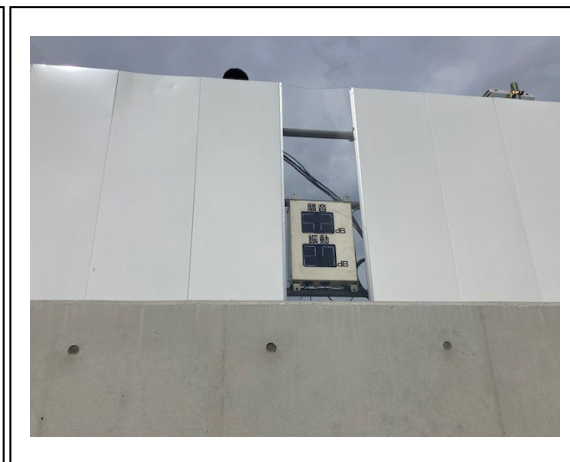
写真 2.2.13b 仮囲いモニター (騒音・振動計の表示)
