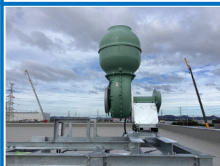
①卸売場棟ピット換気 屋上排気ファン
