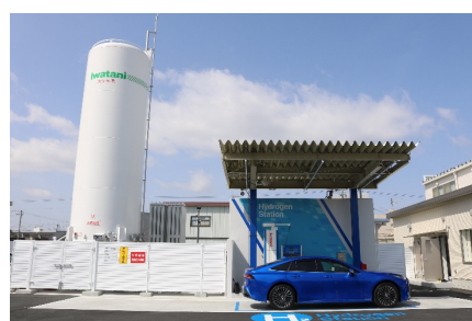
水素ステーション（姫路市）
