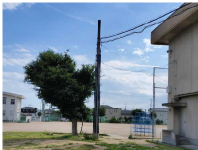
㉒敷地内電柱 既存図面よりプール付属棟への 電源供給用と推定
