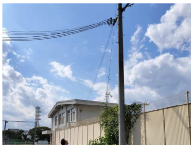
㉖スポーツクラブ事務所強電引込 敷地内電柱より引込
