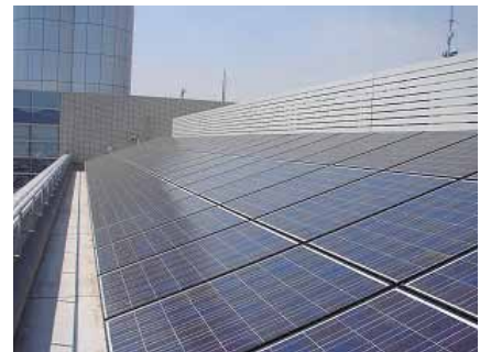
▲姫路市防災センターの太陽電池パネル
