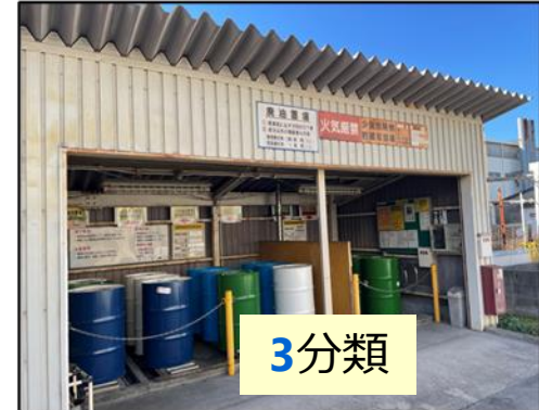
各種 機械・水系 廃油 保管庫
