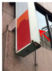
広告板底部の腐食が進行した状態
