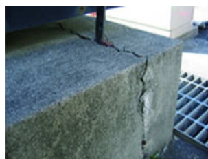
基礎にクラックが入った状態
