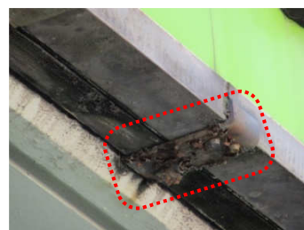
金具が劣化した状態
