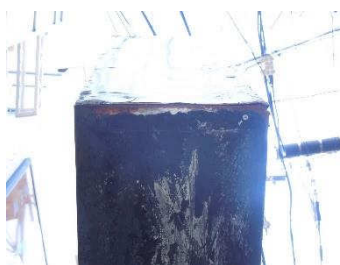
側板底面にさびが発生した状態
