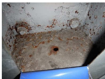
劣化した状態
