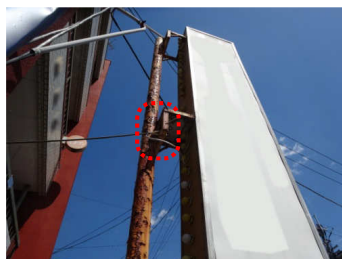
支柱・ブラケット接合部が腐食した状態
