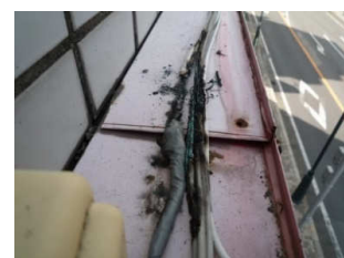
配線が劣化し、ショートした状態
