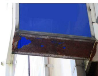
側板底面が腐食、破損した状態
