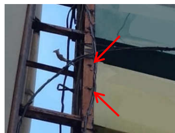
ボルトのゆるみや欠落した状態
