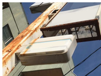
支柱にさびが発生した状態
