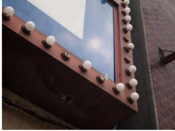
ランプ球が破損した状態
