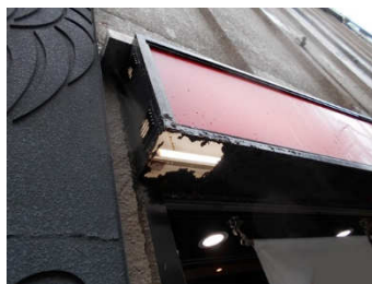
側板底面の腐食が進行した状態
