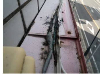
配線が劣化し、ショートした状態
