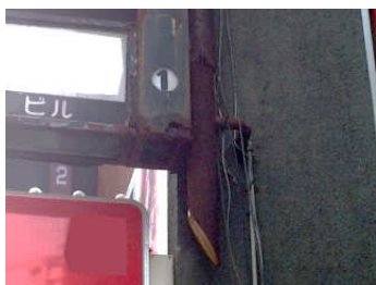
支持部が腐食した状態
