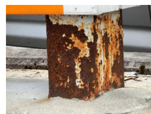
支柱根元の腐食が進行した状態
