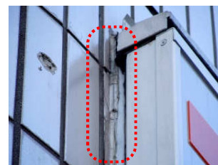
コーキングが劣化した状態
