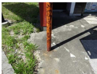
支柱の腐食が進行した状態
