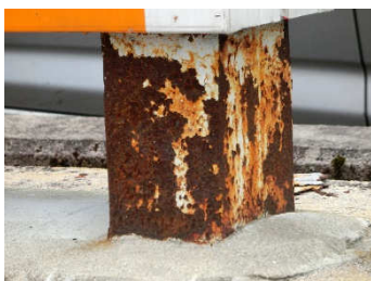
支柱根元の腐食が進行した状態
