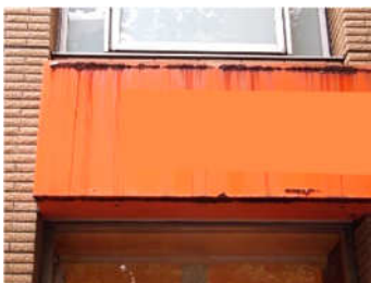
側板の腐食が進行した状態
