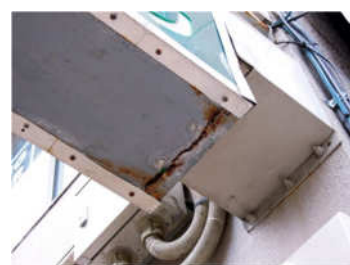
側板底面が破損した状態
