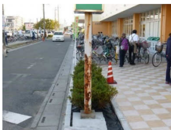
支柱の腐食が進行した状態
