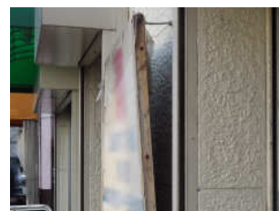
壁面との間に隙間が生じた状態
