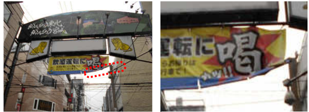
幕材を張る部材が破損した 状態（左図拡大）
