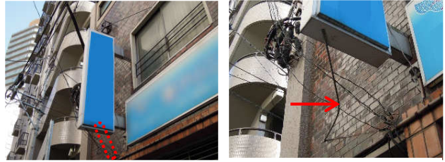
振れ止め棒が変形した状（左図拡大） 態
