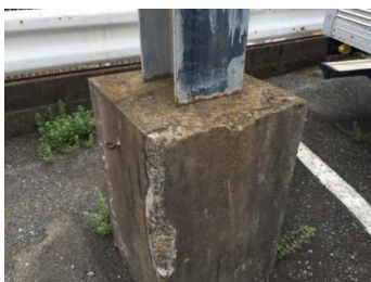
根巻きコンクリートが劣化し、支柱、ベースプレート、アンカ支柱根元の腐食が進行した状態
