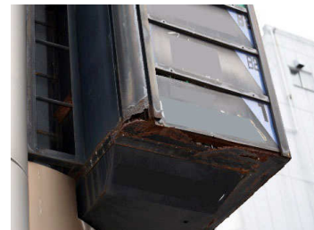
側板底面が腐食、破損した状態
