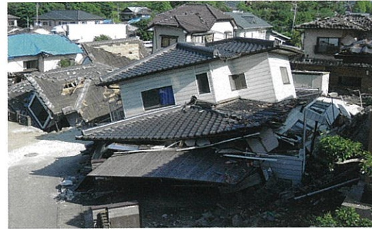
地震による被害例（熊本地震）
