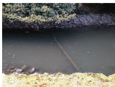
⑭ 配管（勢隠堀内）
