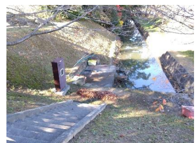
⑮北部ポンプ施設
