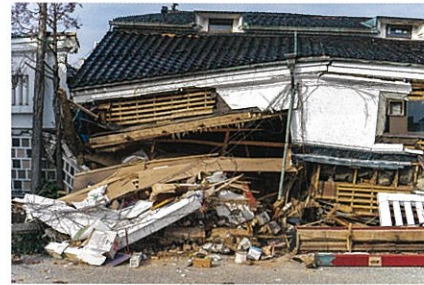
地震による被害例 (能登半島地震)
